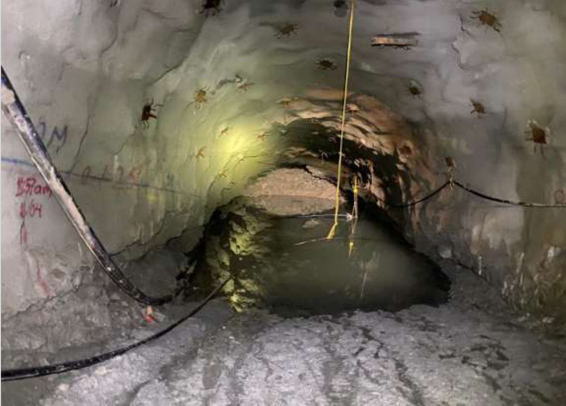
Imagen 11. Extracción de agua en Túnel de Acceso.
