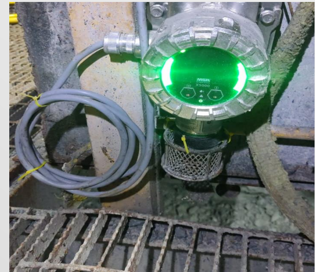
Foto 3. Colocación de sensores fijos para el monitoreo de Metano (CH4).
