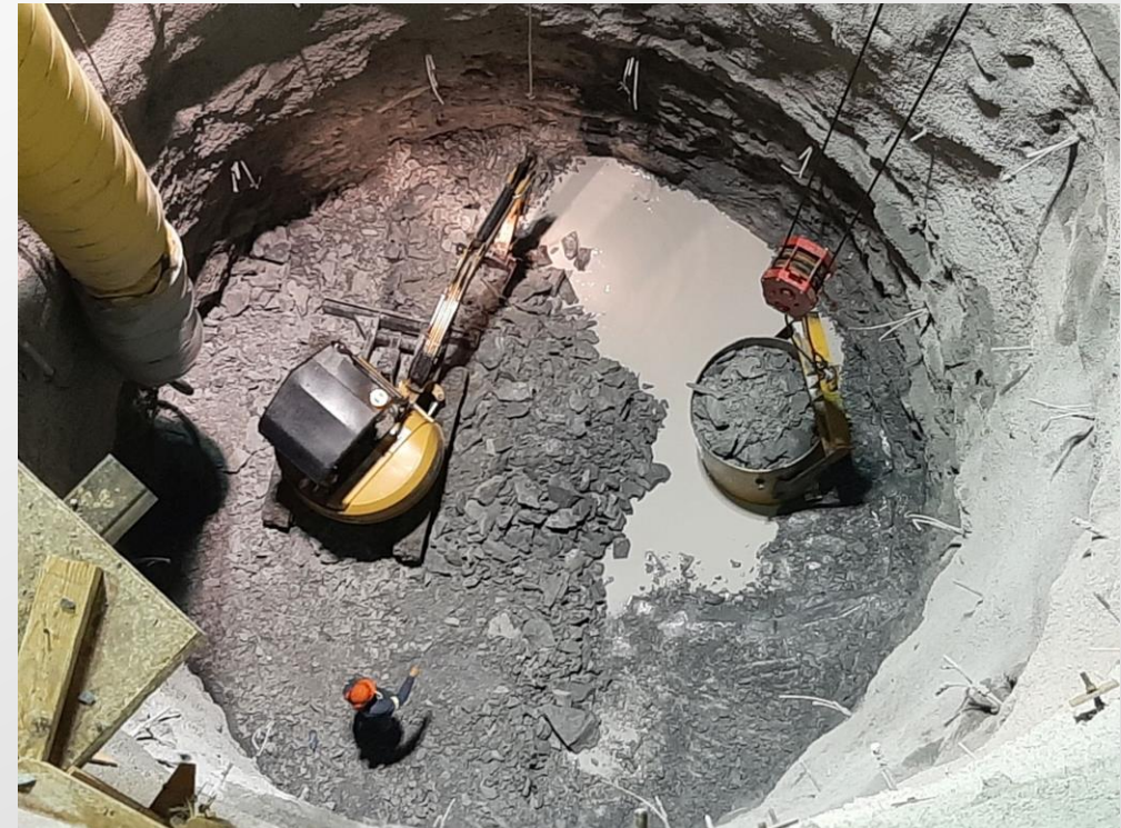
Figura 6: Retiro de material producto de la excavación mediante el sistema de rezagado en la lumbreira PCT-2
