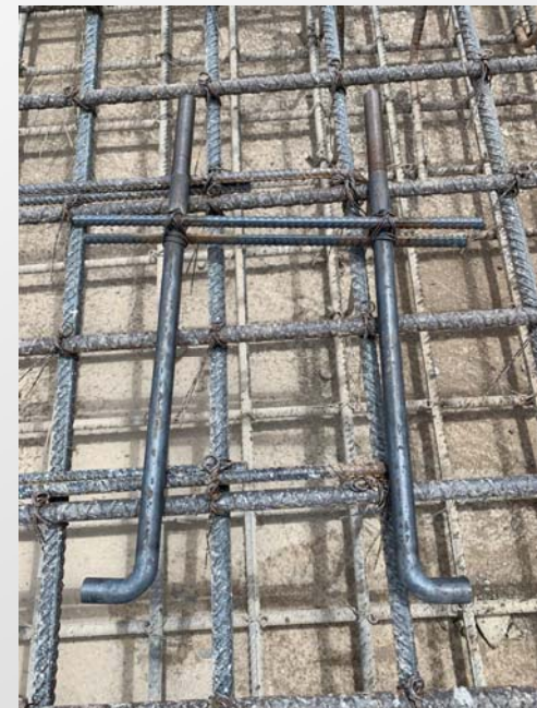
Figura 11: Anclas o bastones que forman parte del sistema de sujeción de los rieles de la grúa pórtico.
