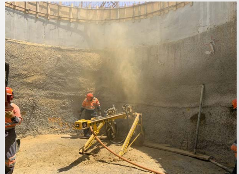
Figura 1: Perforación de la segunda línea de anclas de 6,00 m en la lumbrera PCT-1.
