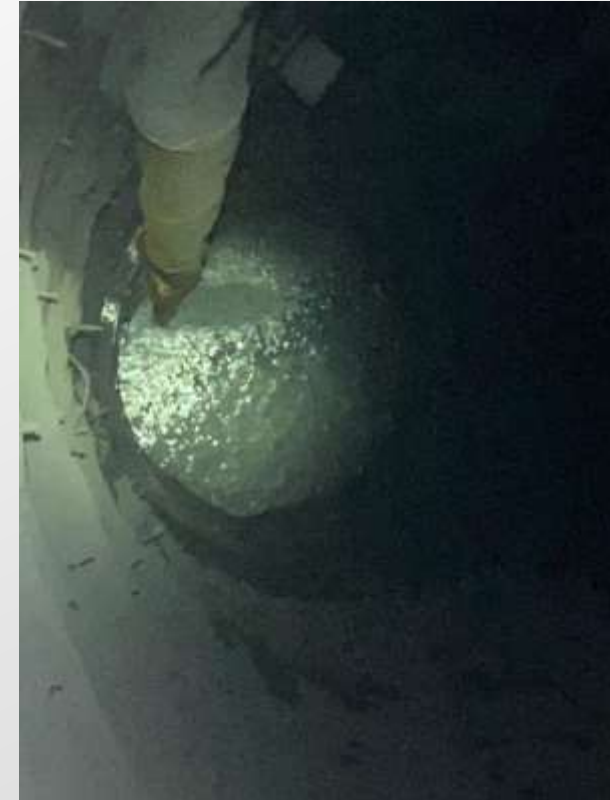
Figura 7: Bombeo de agua en tiro vertical de PCT-1
