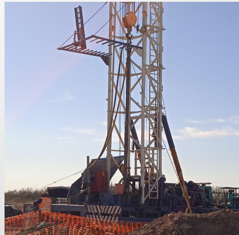
Imagen 12: Trabajos de perforación del pozo PCE-04 . Se concluyó la perforación con un diámetro 12" \frac{1}{4} (158 m) y se llevan 138.00 m con diámetro de 19". Esta en gestión su equipamiento.
