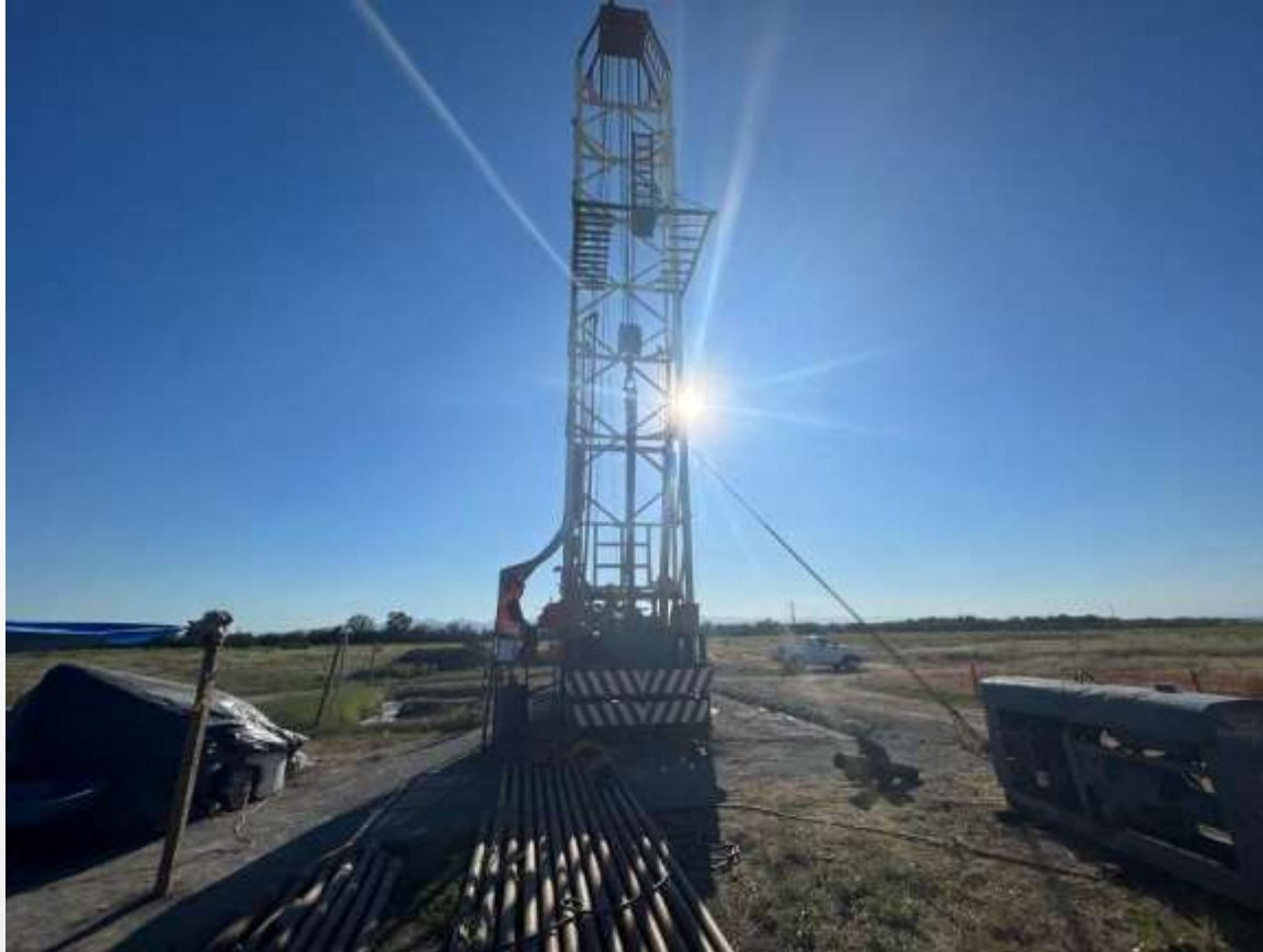
Figura 3: Extracción de agua en el pozo PCV-02 , con descarga en el cárcamo aireador.
