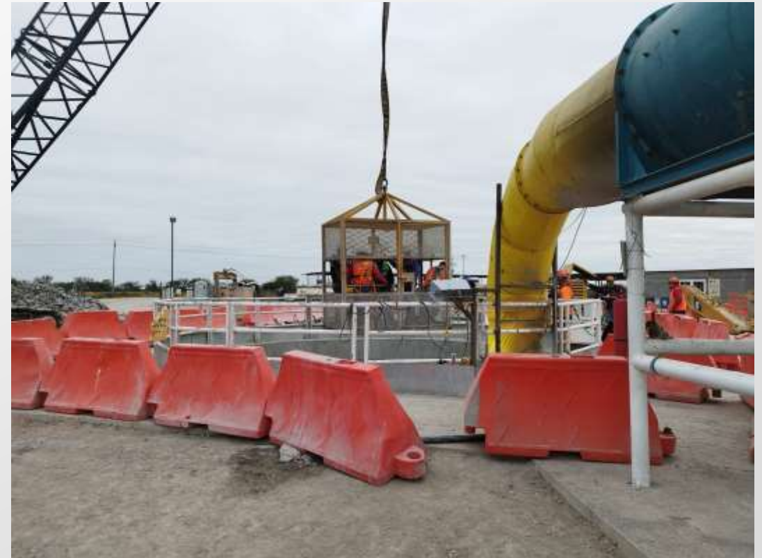
Figura 5: Bajada de personal para verificación en pruebas de resistencia de anclaje en la lumbreira PCT-1.
