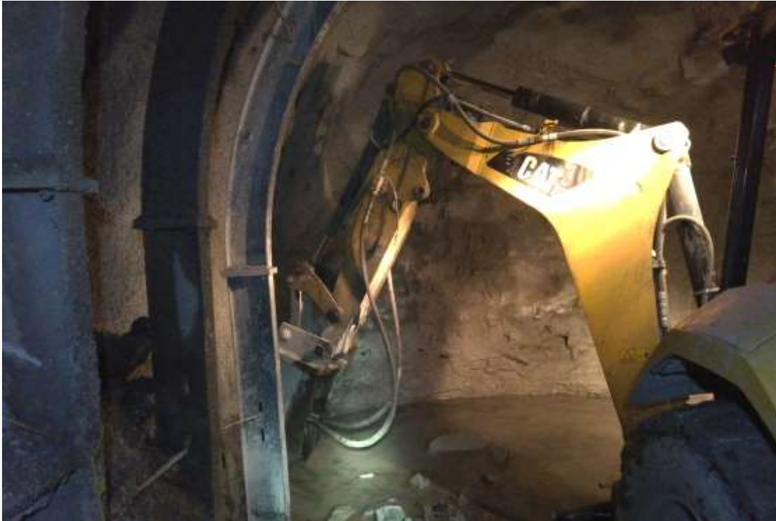
Figura 1: Perfilado de las paredes del túnel de acceso, con retroexcavadora, después del marco metálico.
